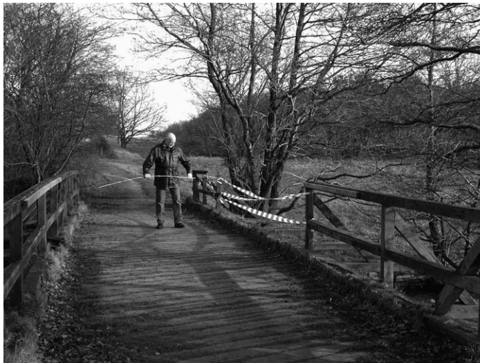
Gerhard Flottmann weist auf die Schäden an der Reservistenbrücke hin
